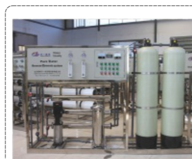
水处理 /Water Treatment
