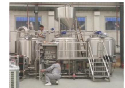
系统试机 System Testing
