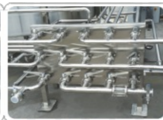
管板 / Piping Manifold
